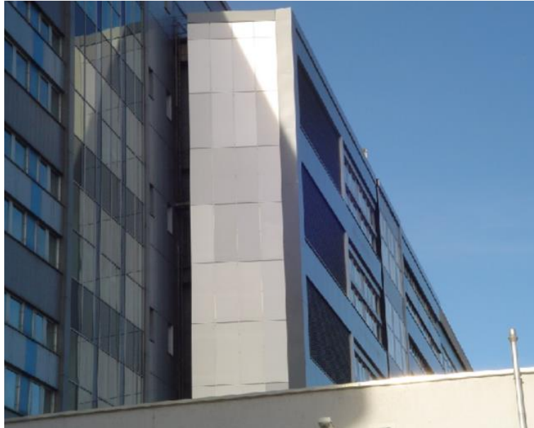
Abbildung 1 - sichtbare Farbunterschiede an eloxierten Fassadenverkleidungen
